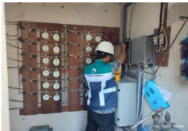
PENGUKURAN VIBRATING WIRE PIEZOMETER
